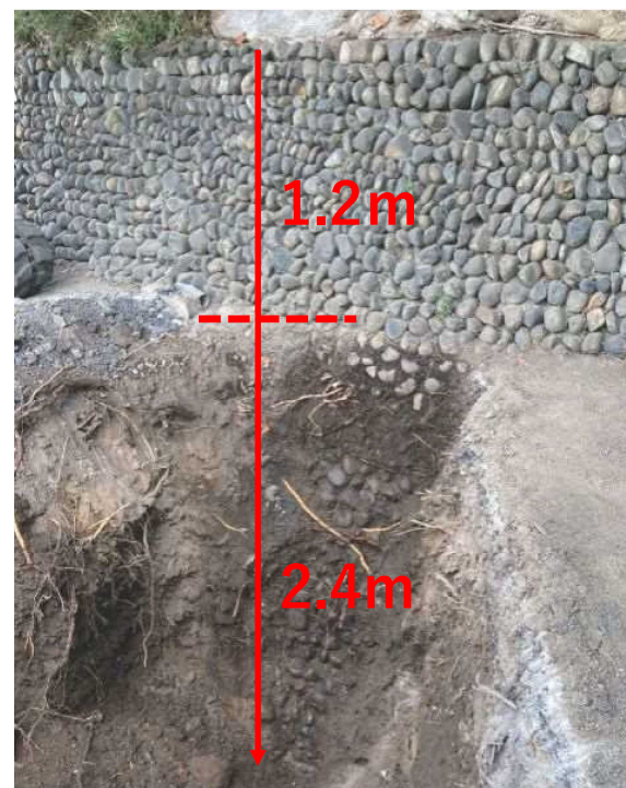
石垣下部の埋没状況
